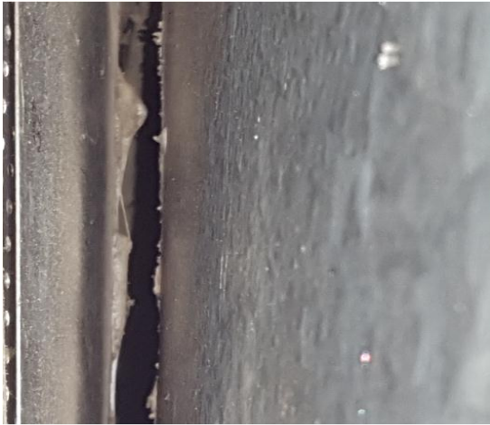
Kuva 6. Tuloilmakoneen liitos runkokanavaan on repeytynyt.
