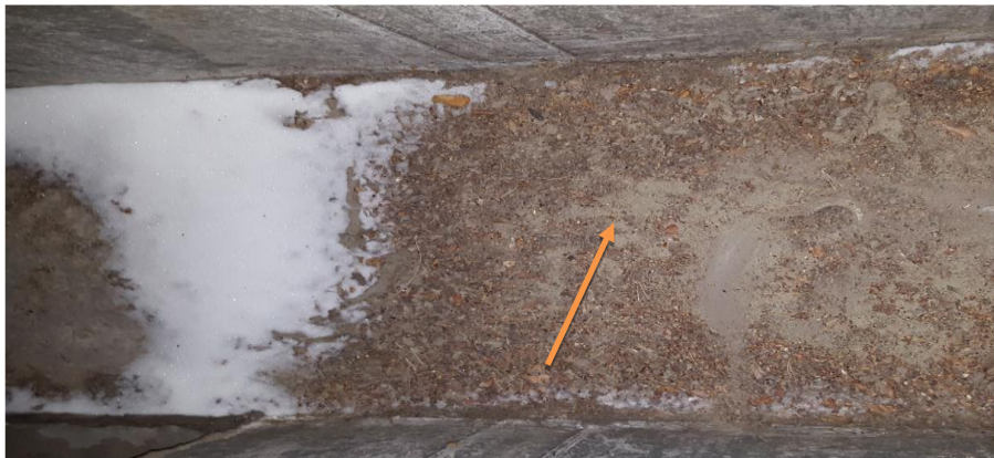
Kuva 5. IV-konehuoneen raitisilmakammio on likainen, kammion pohjalla on lunta ja viemäröinti on tukossa
