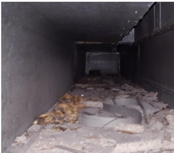
Kuva 8. Salin alla kulkevassa tuloilmakanavassa on rakennusaikaista jätettä.
