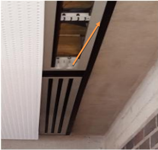
Kuva 10. Tila 024, Tulo- ja poistoilman pääte-elimet ovat yhdessä suorassa linjassa katossa.
