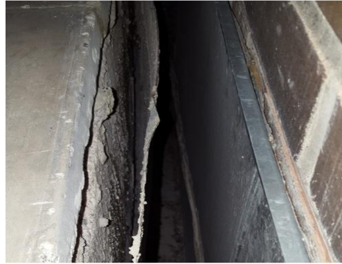
Kuva 2. Pääte-elimien sovitukset rakenteeseen on epätiivis.
