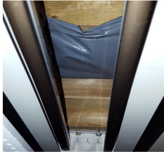
Kuva 11. Tuloilmaelimen taustapinnassa on vapaita villapintoja.
