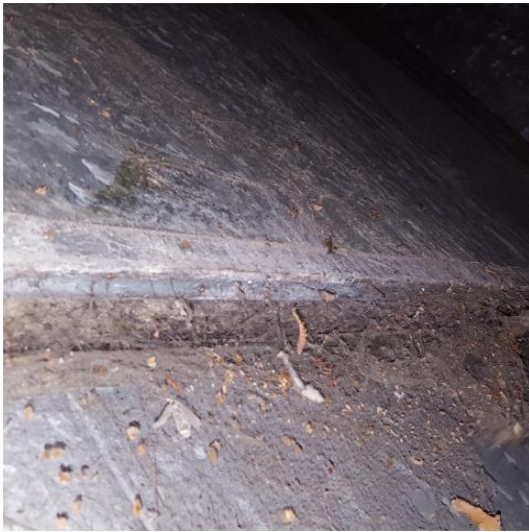
Kuva 3. Raitisilmakammiossa on likaa ja avoimia villapintoja.
