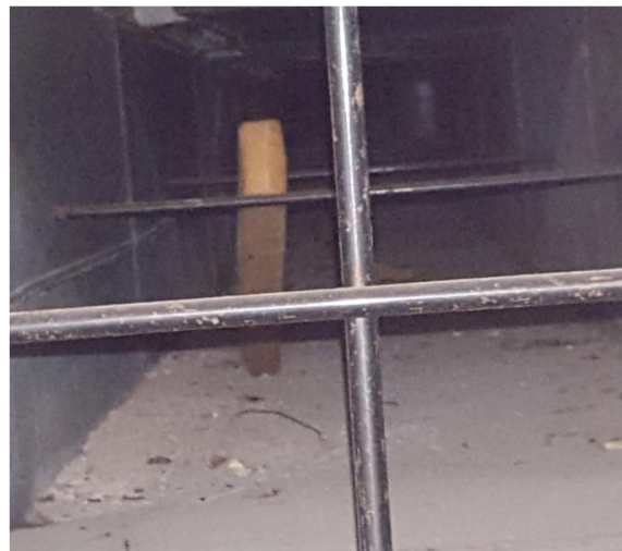
Kuva 9. Salin alla kulkevassa tuloilmakanavassa on metallisia tukiristikoita.
