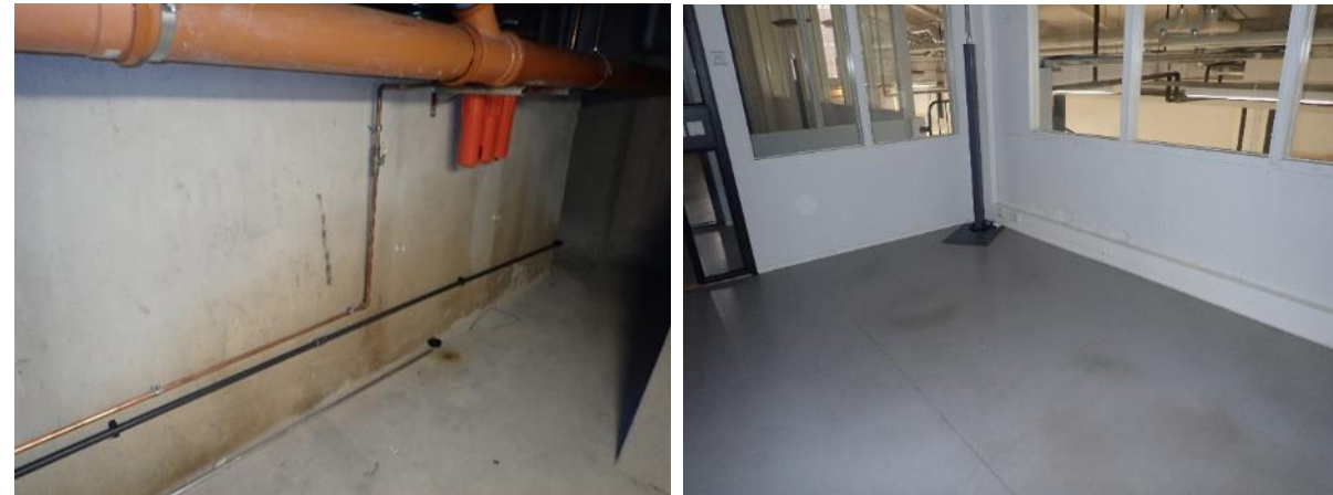
Kuva 14. Kellertävää värjäytymää seinän alaosassa. Tilassa oli voimakas öljyhiilivetyihin viittaava haju.
