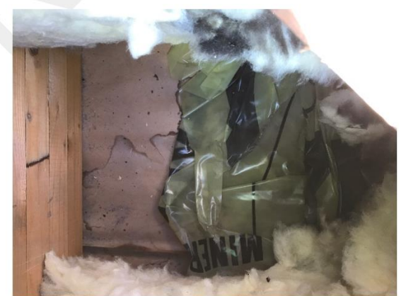
Kuva 170. Alumiinipaperissa ja kipsilevyn sisäpinnassa on kosteusjälkiä.
