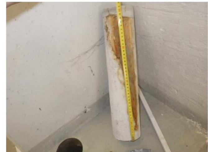
Kuva 44. Pilarin asennuskiilassa todettiin lahovaurioita.
