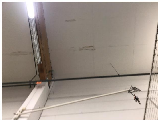
Kuva 154. Korjaamo-osan yläpohjarakenteen alapinnassa vuotojälkiä
