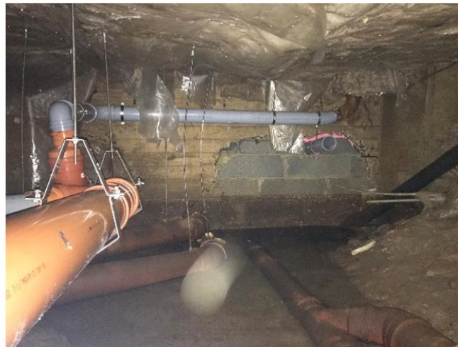
Kuva 20. Maaperän pinnalla on irtovettä. Betonirakenteissa on näkyvissä tiivistynyttä kosteutta.
