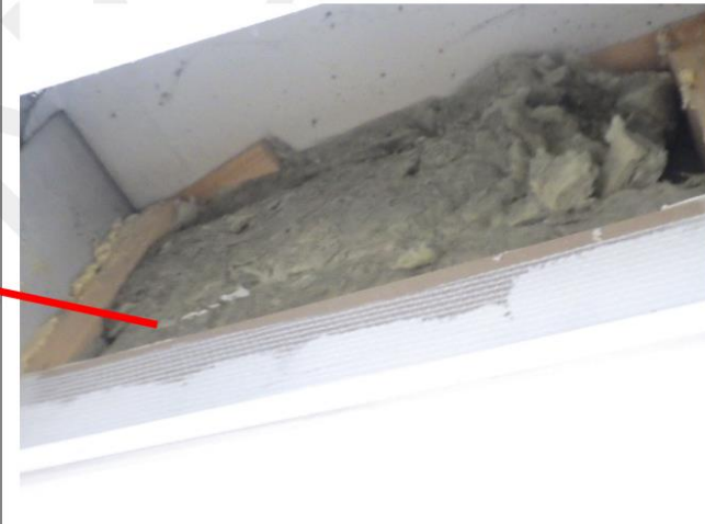
Kuva 115. Ulkoseinän mineraalivillat ovat suojaamatta alakattotilassa.
