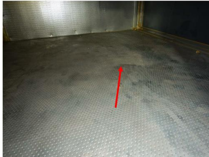
Kuva 24. Puhaltimen jälkeisessä äänieristetyssä kammiossa on pölykertymää.
