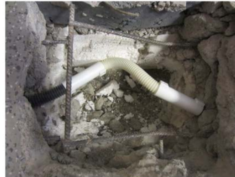
Kuva 24. RA3. Avauskohdalla alapohjan ja ulkoseinän liittymä ei ole tiivis.
