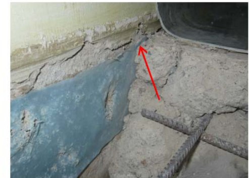
Kuva 27. RA4. Liittymä ei ole tiivis.
