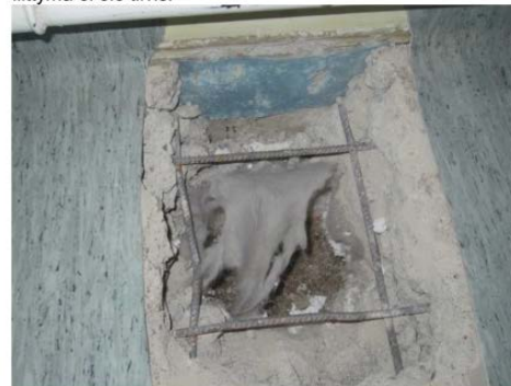
Kuva 26. RA4. Avauskohdalla voimakas mikrobeihin viittava haju.
