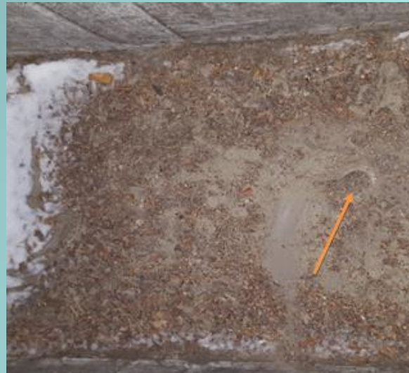
Iv-konehuoneen raitisilmakammio on likainen, kammion pohjalla on lunta ja viemärointi on tukossa
