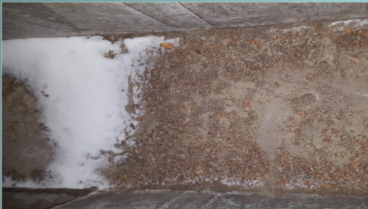
Kuva 44. Raitisilmakammio on likainen, kammion pohjalla on lunta ja viemärointi on tukossa.
