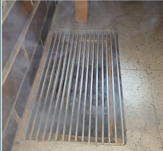
Kuva 41. Salin alla kulkevasta putkikuilusta siirtyy ilman epäpuhtauksia oleskelutiloihin.
