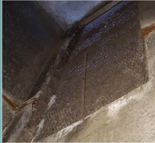
Kuva 43. Lumisäleikkö (Iv-konehuone 02) on tukossa.
