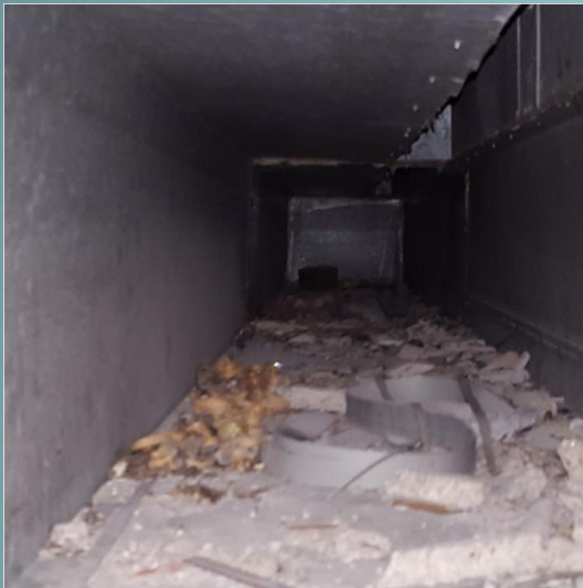
Salin alla kulkevassa tuloilmakanavassa on rakennusaikaista jätettä
