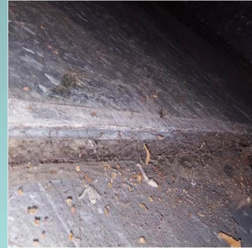
Kuva 42. Raitisilmakammiossa on likaa ja avoimia villapintoja.
