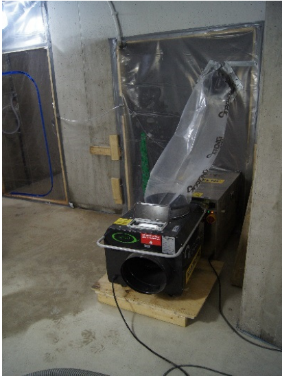
Tilojen hallittu ylipaineistus
