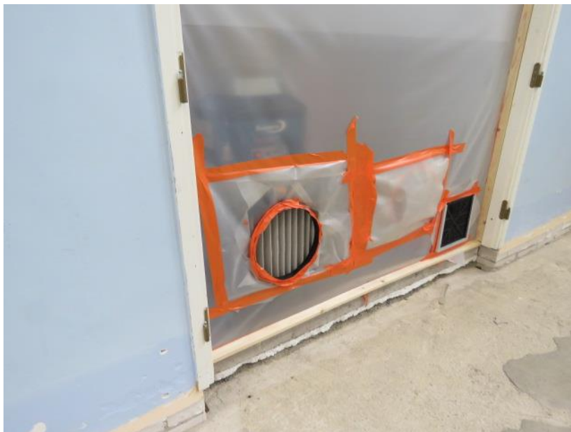
Kuva 2. Alipaineistuskoneet sijoitettu osastoinnin ulkopuolelle.
